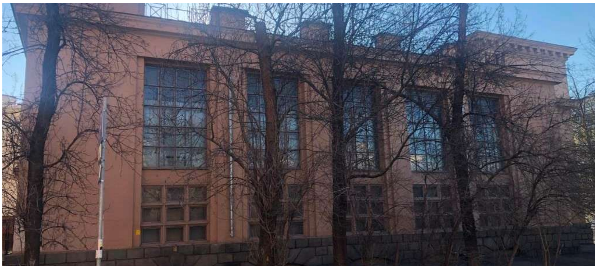
Обследования выявленного объекта культурного наследия «Электрическая станция, кон. 1930-х-1940-е гг. с оградой» по адресу: г. Москва, ул. Колпачный пер., д 13, стр.1, разработка проекта противоаварийных мероприятий, конструктивных и объемно-планировочных решений.
