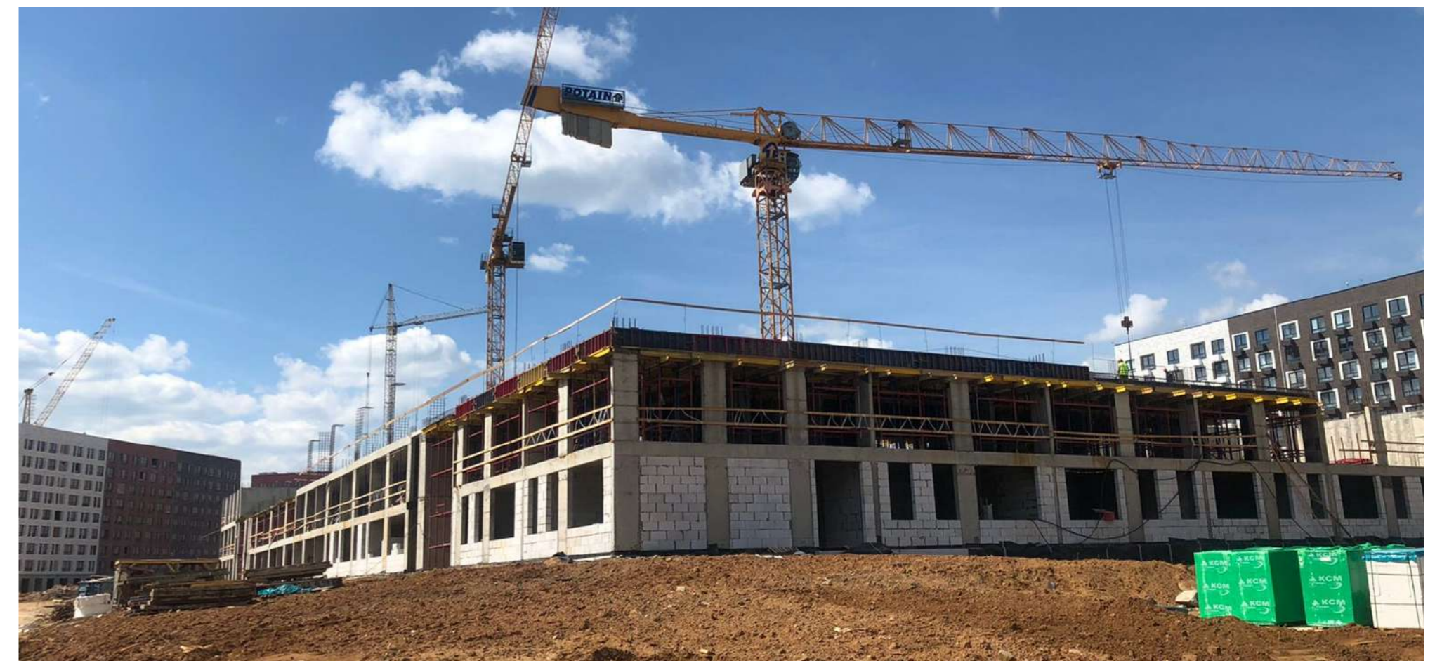
Лабораторное сопровождение строительства на объекте «Жилой комплекс, школа на 1500 мест, расположенная по адресу: Московская область, Красногорский муниципальный район, с.п. Ильинское, вблизи пос. Ильинское – усово»
